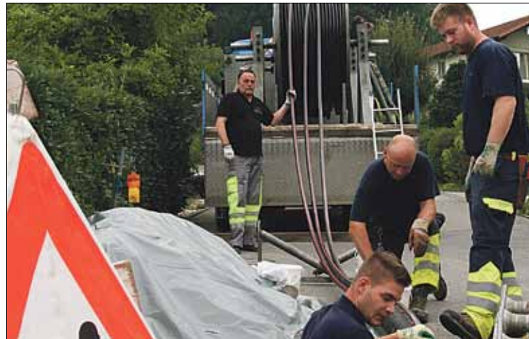
CKW-Monteur verlegen im Rontal neue Kabel. Damit sollen in Zukunft grössere Stromunterbrüche verhindert werden. Bild pd.
