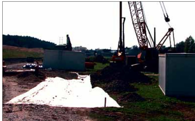
Die ersten Maschinen und Baucontainer sind auf der KVA-Baustelle in Perlen installiert. 2016 wird die neue Anlage den Vollbetrieb aufnehmen.
