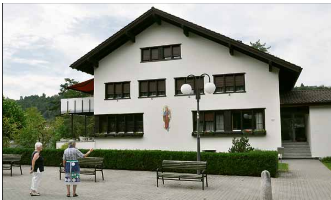
Erstrahlt über das Dorf in neuer Farbe: Das Ebikoner Pfarrhaus wurde in den vergangenen fünf Monaten einer umfassenden Sanierung unterzogen.
