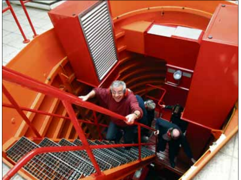
Franz Zosso steigt aus dem Turbinenraum.
